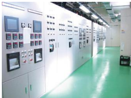
▲各種制御盤製作
