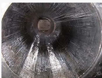
スリーブ内径摩耗
