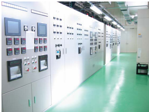
▲各種制御盤製作
