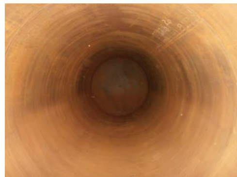
地下タンクFRPライニング前 設置後約30年で腐食し 液漏れの可能性あり。
