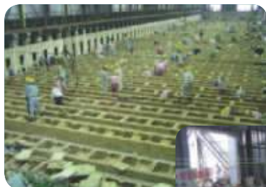
▲燃焼室煉瓦積
