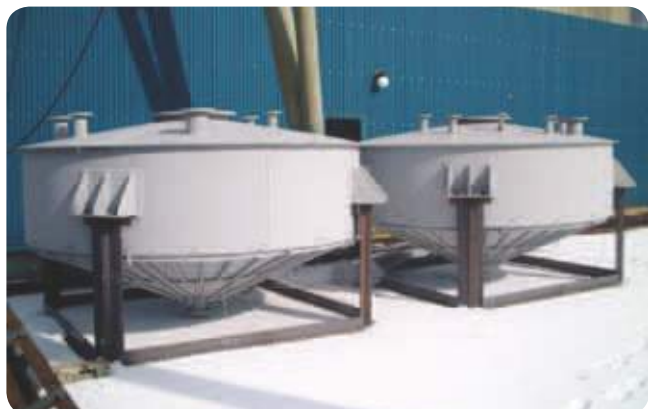
▲タール安水タンク
