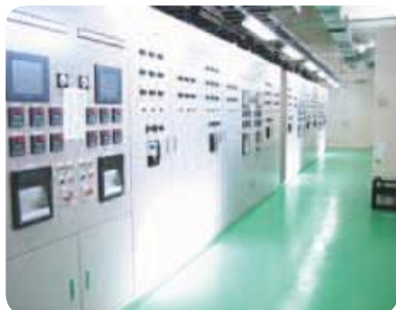
▲各種制御盤製作
