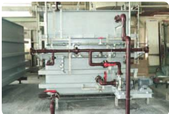
▲ FRP 製メッキ槽 配管
