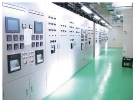
▲各種制御盤製作
